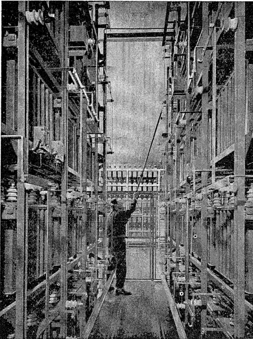
Fig. 9 - Batterie di condensatori dell'impianto di alimentazione.
