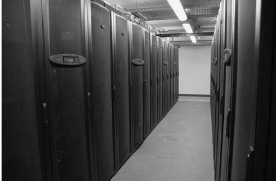
Figura 3 - Esempio di rack e CRAH disposti a formare delle isole con compartimentazione dell'aria calda (HACS).
